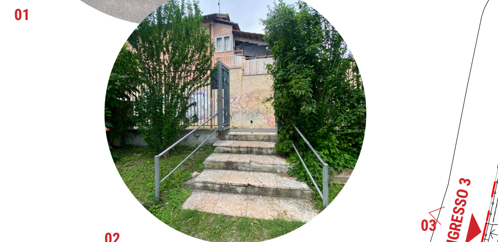
03 INGRESSO 3 DA VIA MADRE RUBATTO: presenza di barriere architettoniche (gradini) e percorso in ghiaia non fruibile da persona su sedia a ruote
